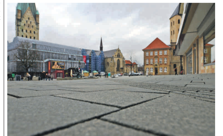
Das neue Pflaster auf dem Marktplatz: Wegen des Weihnachtsmarktes werden die Arbeiten zunächst einmal ruhen.
